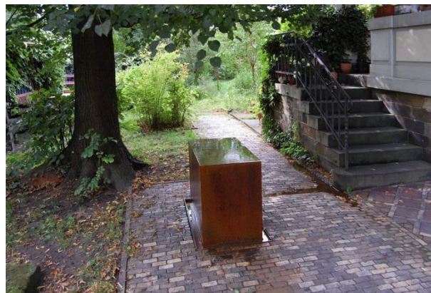
Abb. 29: Pumpe unter Kontrollschachtabdeckung (links) und Wasserverteilungsbox (Bildmitte), kombiniert mit der Regenwassernutzung statt Zisterne
