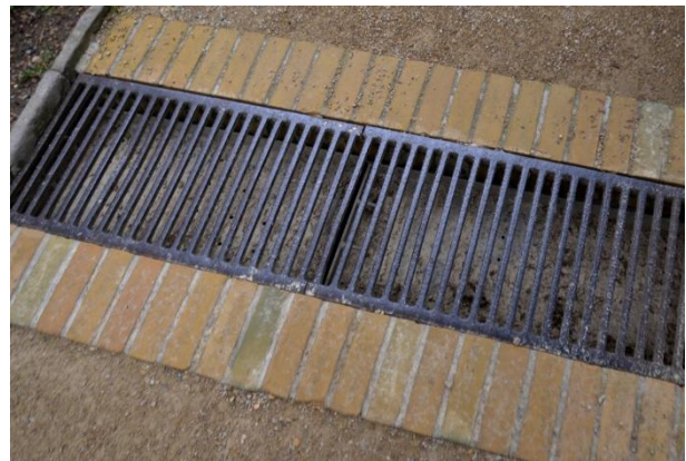
Abb. 10: Einlauf im Weg leitet Starkregen in darunterliegenden Sickerschacht
